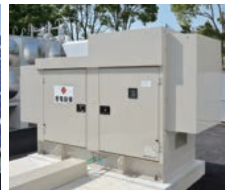
自家発電設備 90kVA×1台
