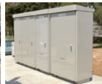
電力変換盤 20kW×1式
