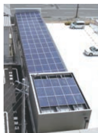
太陽光発電設備
