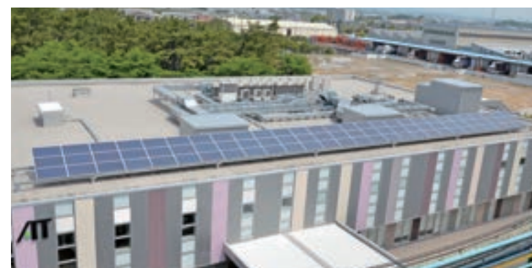
太陽光発電設備
