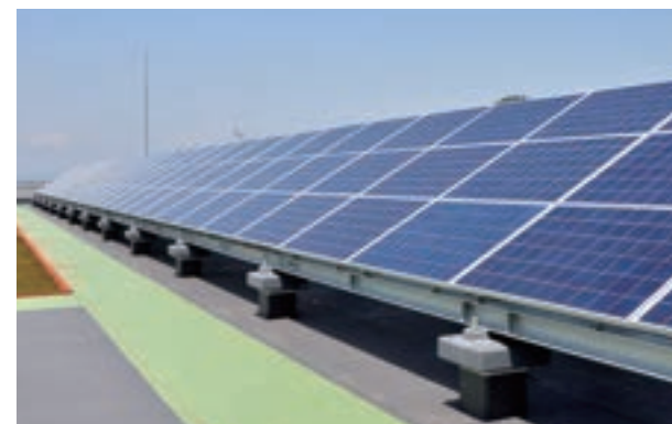
太陽光発電設備 20kW×1式
