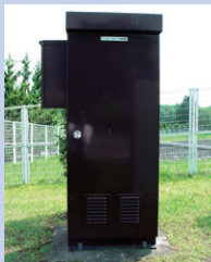
公共 MHP × 3 (全体 6 箇所)
