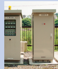
大用地地区 水処理センター (小規模集合排水)
