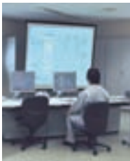
監視制御システム
