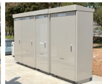
電力変換盤 20kW×1式
