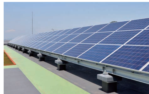
太陽光発電設備 20kW×1式
