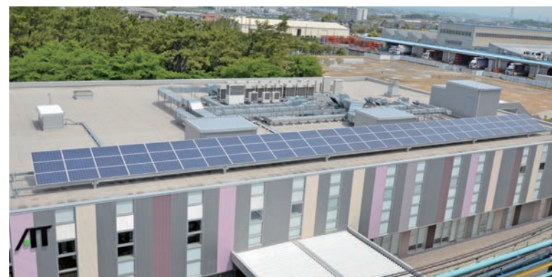
太陽光発電設備
