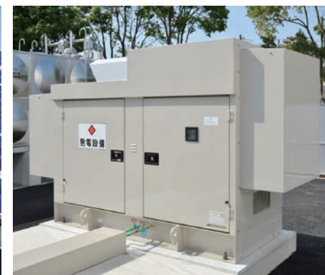
自家発電設備 90kVA×1台
