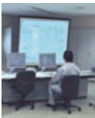
監視制御システム
